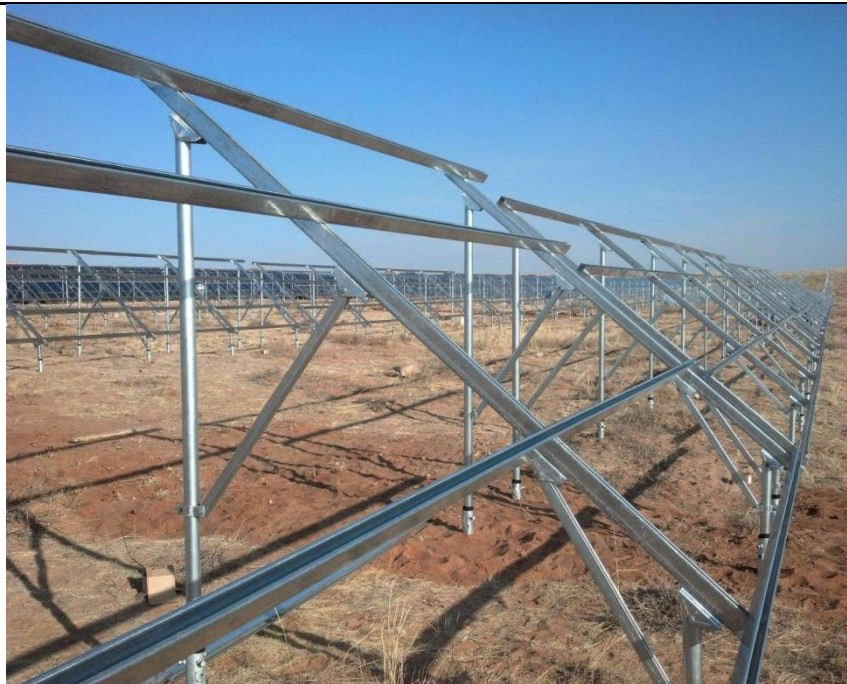
光伏跟踪器的支架结构现状照片
