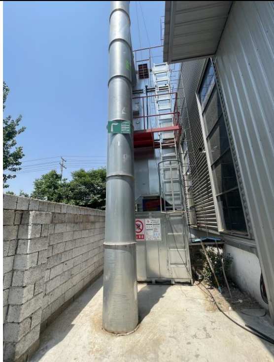
打孔工段布袋除尘及排气筒
