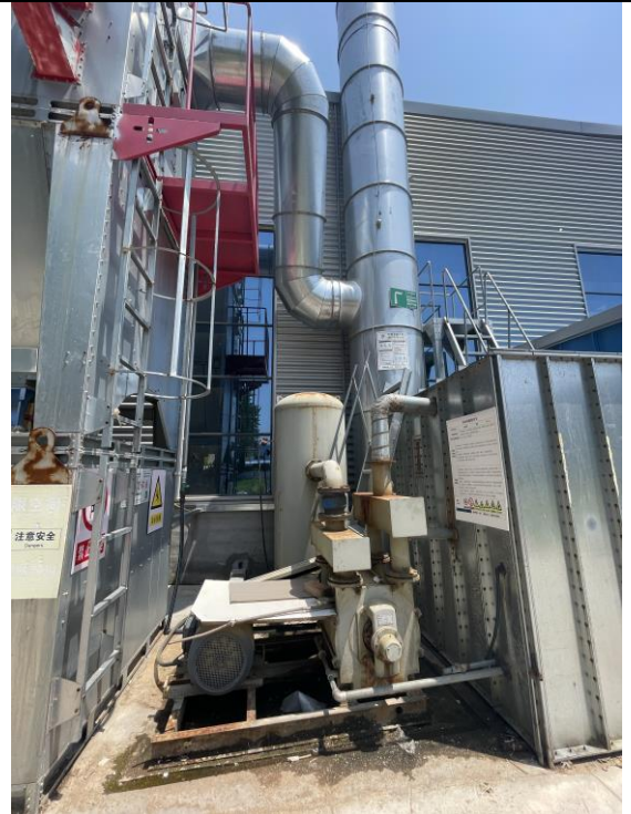
开料工段布袋除尘及排气筒设施
